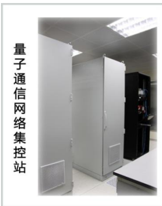
图 20：量子通信网络集控站
